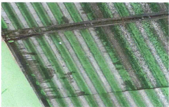
Foto 5: Cambio de techos completo dañado aula No. 1
