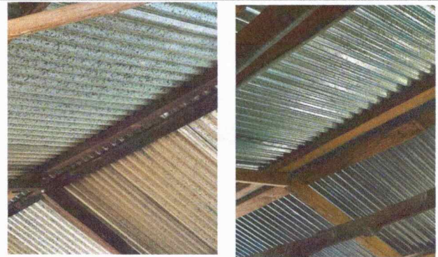
Foto 2: Cambio de techos completo dañado aula No. 2
