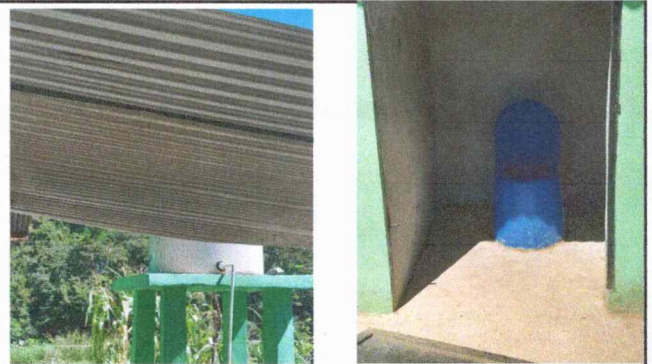
Foto 4: Reparación de las puertas dañadas de los baños, concreto pines de las puertas.
